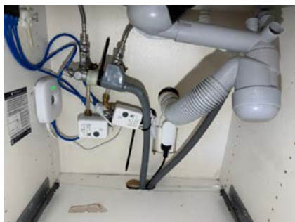
Rørapplegg i kjøkkenbenk
