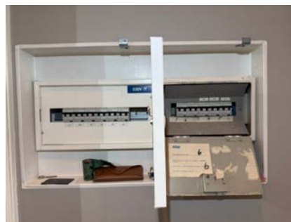
Elskap, plassert i entre.
