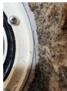
Kuttskader i banemembranen
