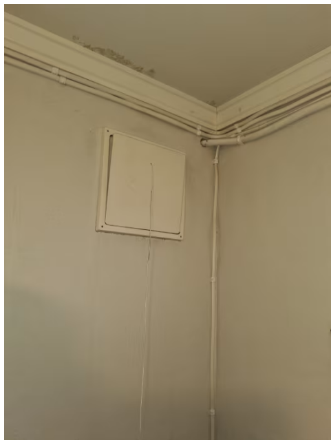
Bilde viser klaffventil på vaskerom.
