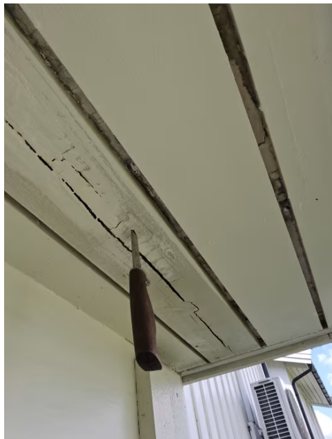
Bilde viser råteskade i himling på terrasse.
