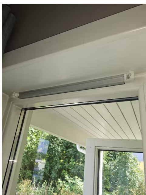
Bilde viser spalteventil i vindu.
