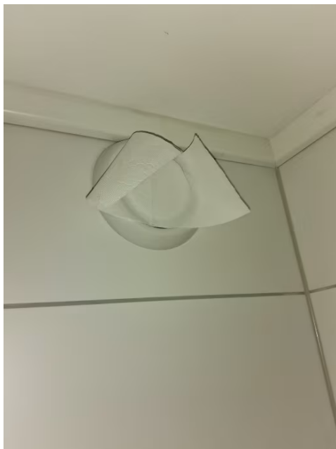
Bilde viser funksjonstest av avtrekk.
