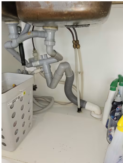
Bilde viser avløpsrør under oppvaskkum på kjøkken.
