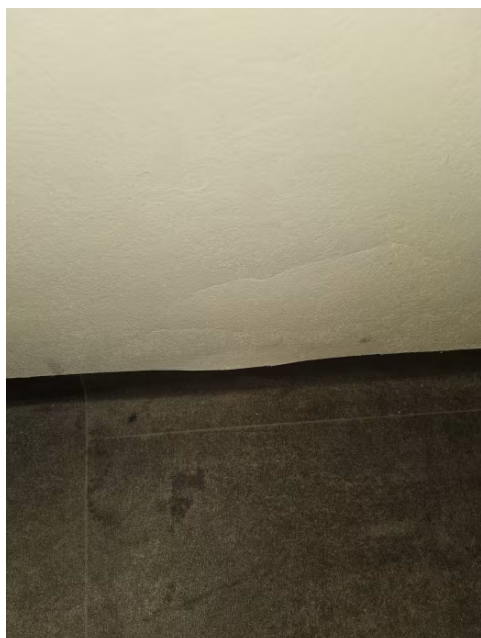
Bilde viser manglende vedheft på våtromstapet.
