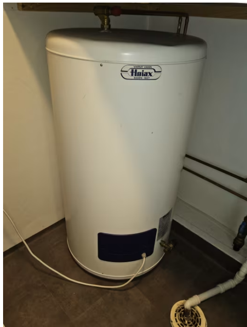
Bilde viser varmtvannsbereder.
