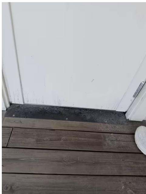
Bilde viser fuktpåvirket terrassedør.
