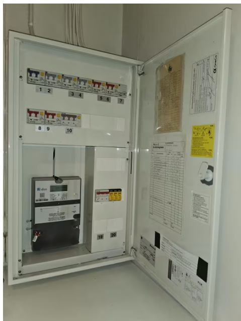
Bilde viser sikringsskap.
