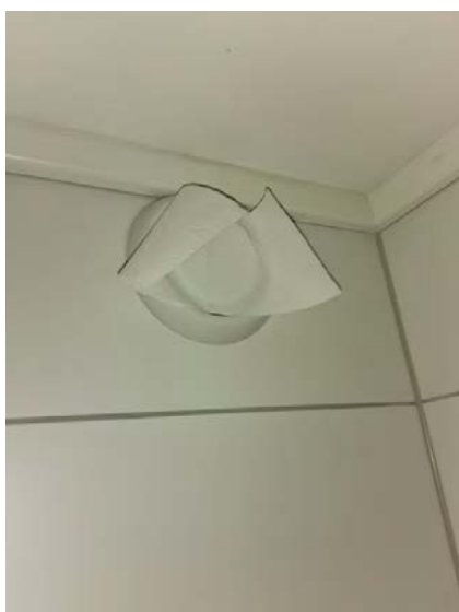
Bilde viser funksjonstest av avtrekk.
