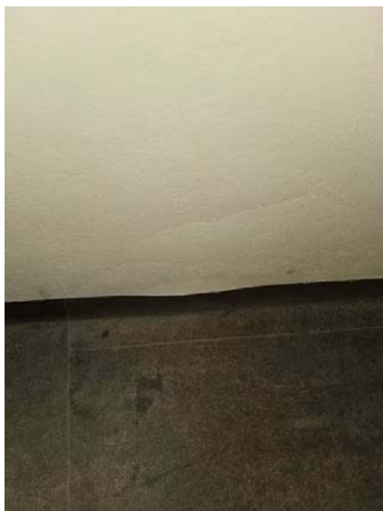
Bilde viser manglende vedheft på våtromstapet.
