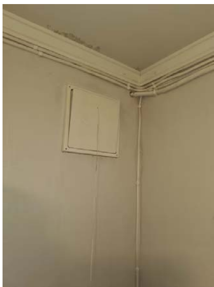
Bilde viser klaffventil på vaskerom.
