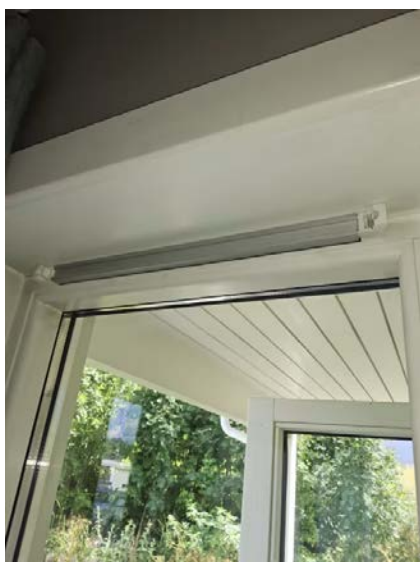
Bilde viser spalteventil i vindu.
