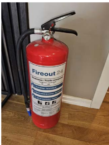
Bilde viser brannslukningsapparat.
