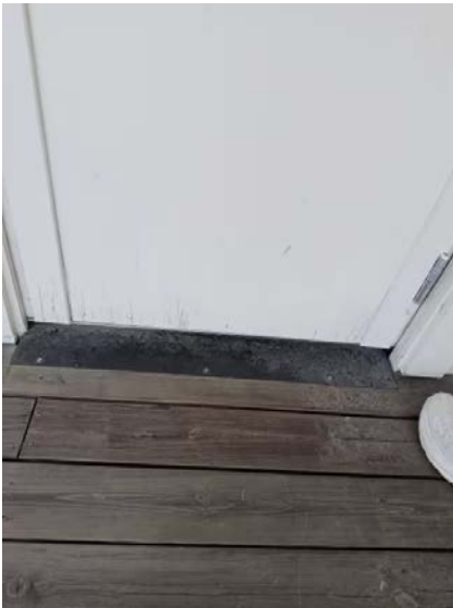
Bilde viser fuktpåvirket terrassedør.
