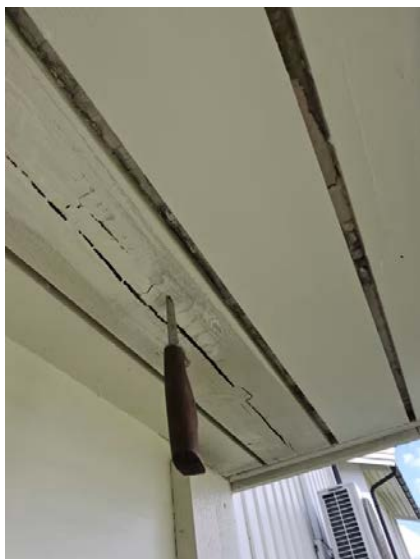
Bilde viser råteskade i himling på terrasse.
