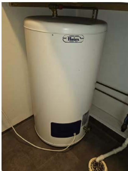
Bilde viser varmtvannsbereder.
