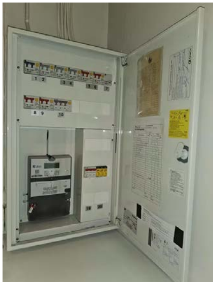
Bilde viser sikringsskap.
