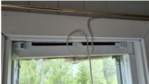
Manglende innvendig reguleringslist på luftespalte i vinduet i entre/gang.
