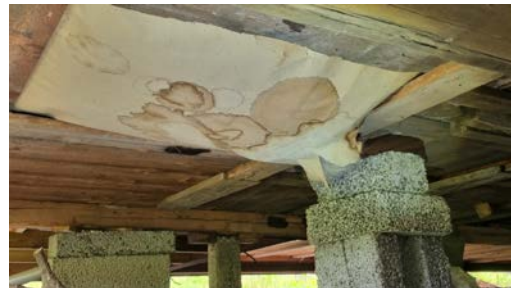
Fuktmerker i del av stubbloft som er tildekket med papp. Usikkerhet angående årsaken til disse fuktmerkene.
