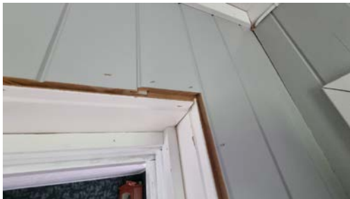
Manglende listverk ved to av dørene.
