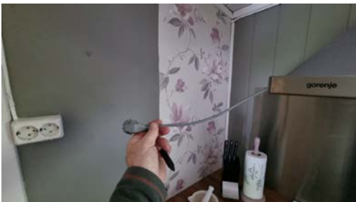
Avtrekket mangler el-tilkobling.
