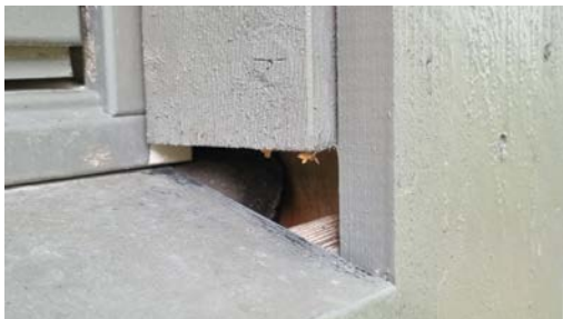
U fagmessig tetting ved "baderomsvinduet".
