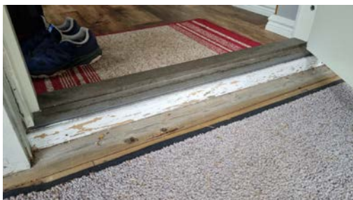
Det er ikke montert utvendig beslag ved dørterskel.
