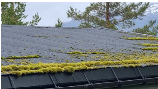
Taket ser "ujevnt" ut fra utsiden.
