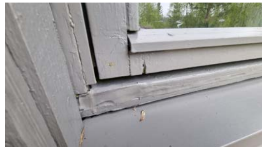
Stedvis er trevirket mykt bak malingen.
