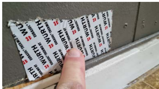
Hull i vegg i stue er tettet med tape.
