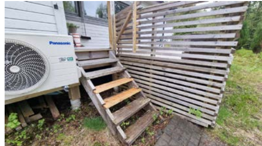
Trapp ved inngangspartiet. Konstruksjonen har svekkelser, samt trappen mangler gelender.
