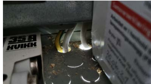
Utettet kabelinnføring i el-skapet
