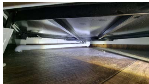
Avløpet fra dusjkabinettet blir ledet direkte til avløpsrør (ikke sluk).
