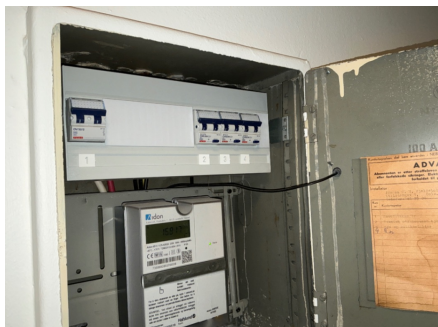
Automatsikringer i sikringsskap plassert i gang/fellesareal.
