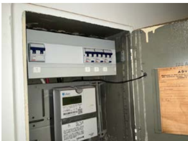
Automatsikringer i sikringsskap plassert i gang/fellesareal.
