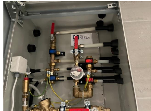
Rørskap på bad.
