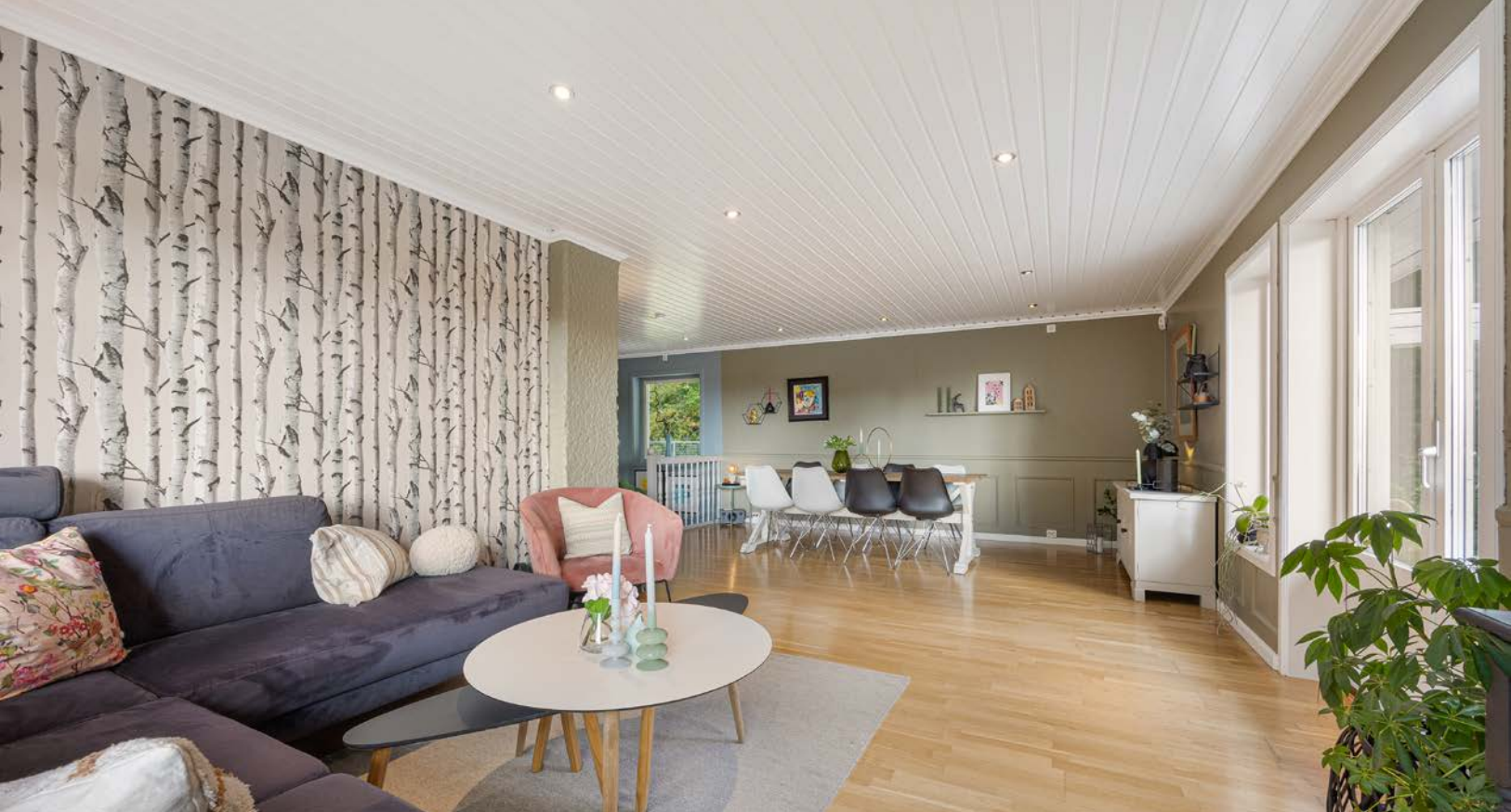
Det er installert downlights i den hvite himlingen.
