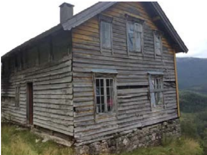
Råteskadet og dels manglende kledning.
