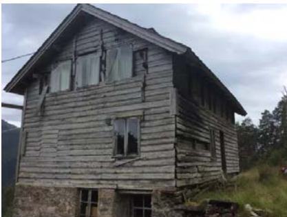
Råteskadet og dels manglende kledning.
