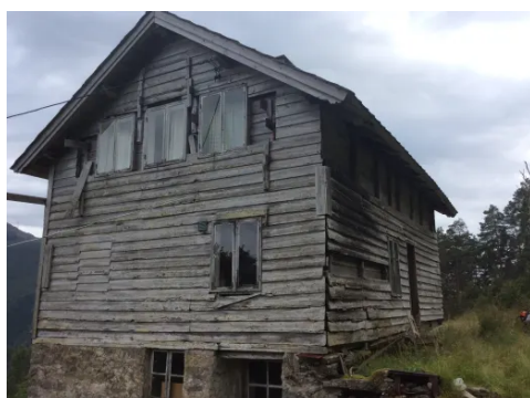
Råteskadet og dels manglende kledning.
