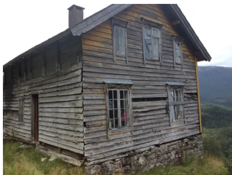
Råteskadet og dels manglende kledning.
