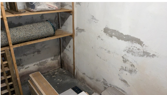
Avskaling på vegg.
