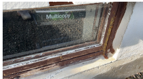
Eksempel på slitasje.
