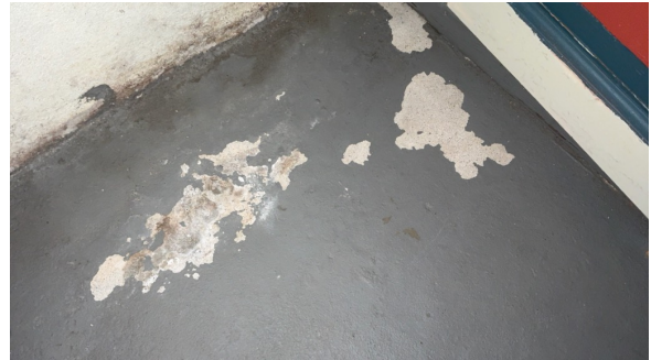
Avskaling av maling på gulv.
