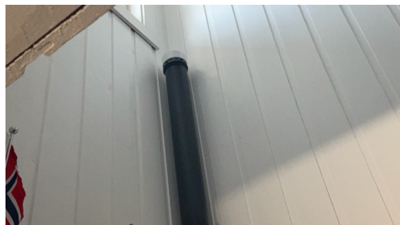
Lufting med ventil i trapperom.
