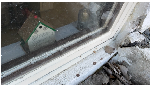
Eksempel på slitasje
