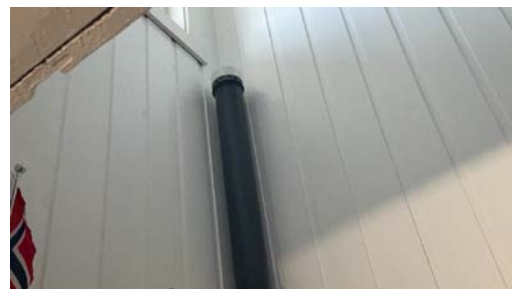
Lufting med ventil i trapperom.
