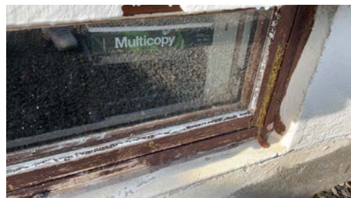
Eksempel på slitasje.
