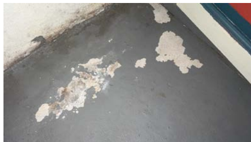
Avskaling av maling på gulv.
