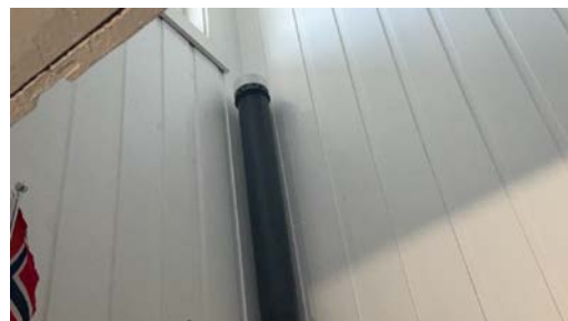
Lufting med ventil i trapperom.
