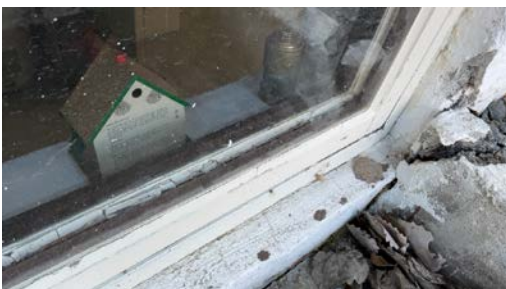
Eksempel på slitasje
