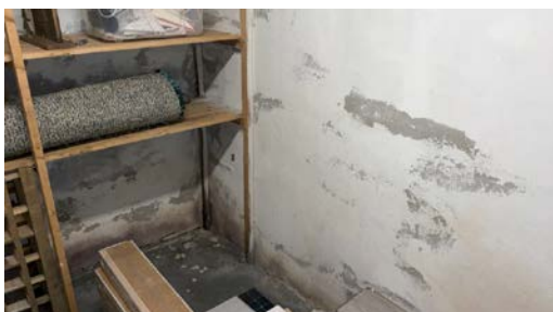
Avskaling på vegg.
