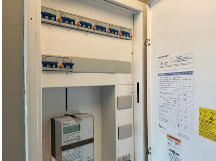
Automatsikringer i sikringsskap plassert i soverom.
