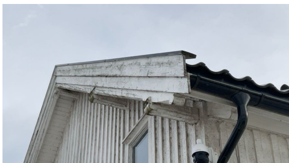
Skade/ slitasje på vindski.
