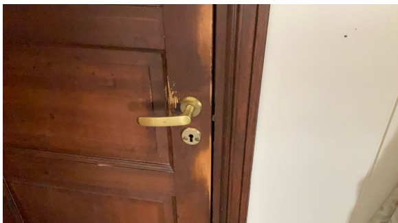
Skade/ slitasje på dør.
