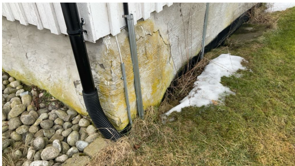
Avskalling på mur.
