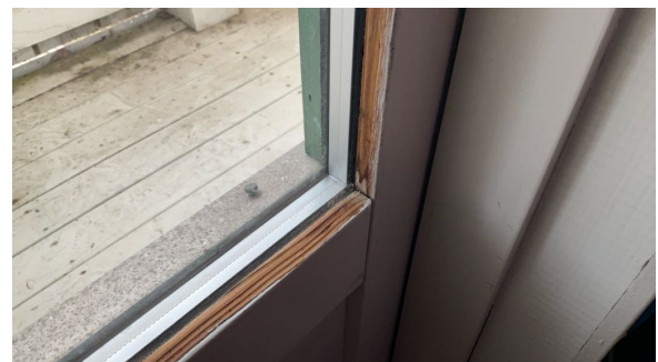
Skade/ slitasje på dør.
