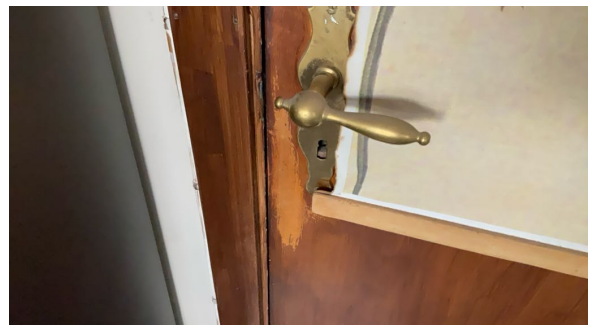
Skade/ slitasje på dør.
