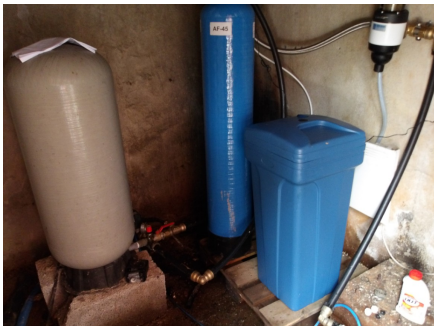
Filter og trykktank for vannbehandling, i pumpehus.
