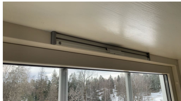
Tilluft fra ventil i vindu
