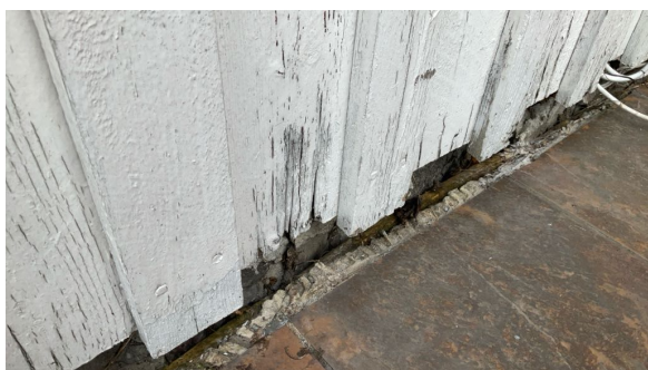
Råteskade på yttervegg.
