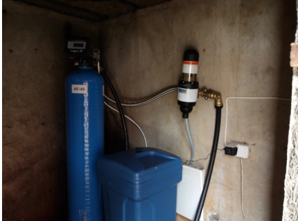
Filter og trykktank for vannbehandling, i pumpehus.
