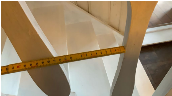
Måling av åpninger i rekkverk på trapp.
