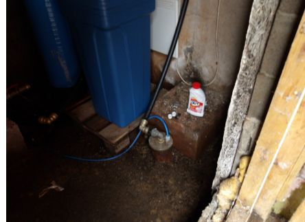
Filter og trykktank for vannbehandling, i pumpehus.
