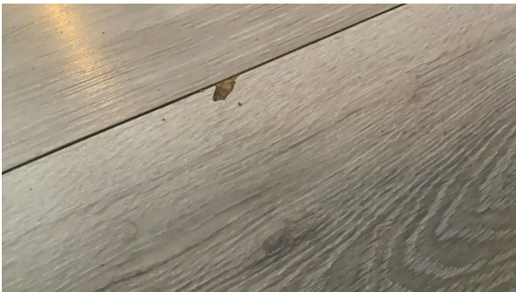
Skade/ slitasje på overflater.
