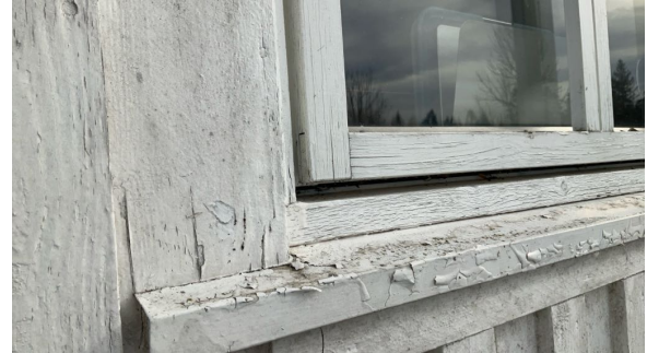
Skade/ slitasje på vindu.
