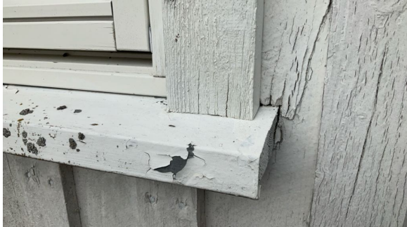
Manglende avstand mellom treverk og vannbrett.
