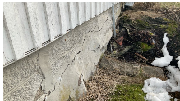
Skade på mur.
