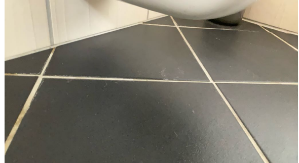
Manglende lekkasjeåpning vegghengt toalett
