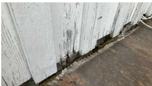
Råteskade på yttervegg.
