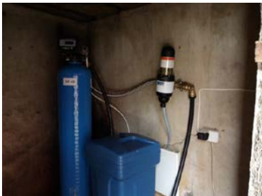
Filter og trykktank for vannbehandling, i pumpehus.
