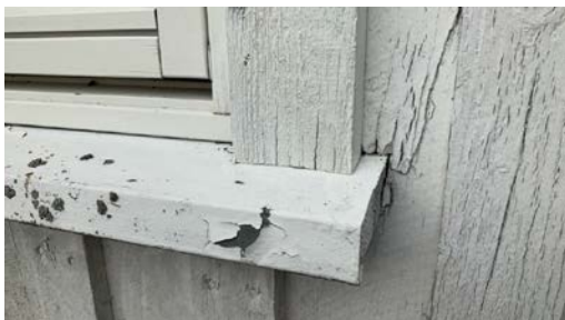
Manglende avstand mellom treverk og vannbrett.
