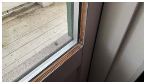
Skade/ slitasje på dør.
