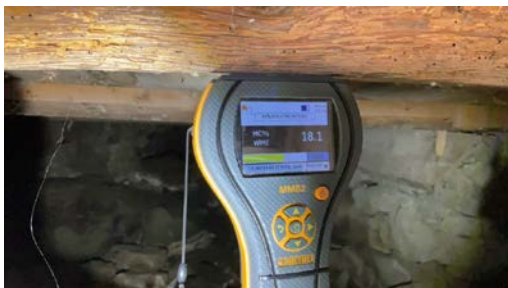
Ved fuktmåling av trekonstruksjon er det registrert måleverdier som ligger i mellomområdet mellom tørt og fuktig.
