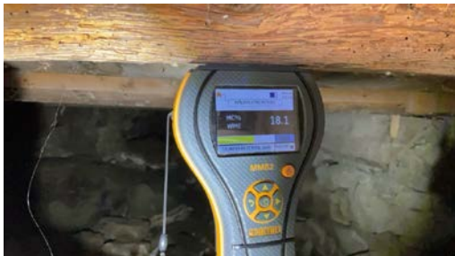
Ved fuktmåling av trekonstruksjon er det registrert måleverdier som ligger i mellomområde mellom tørt og fuktig.
