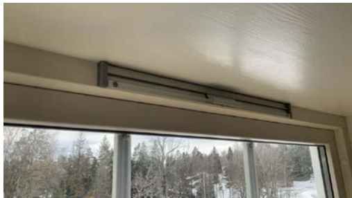
Tilluft fra ventil i vindu
