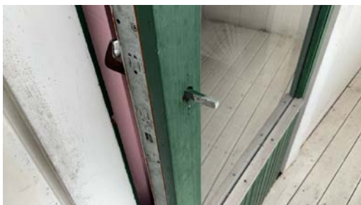
Manglende vridet utvendig på balkongdør
