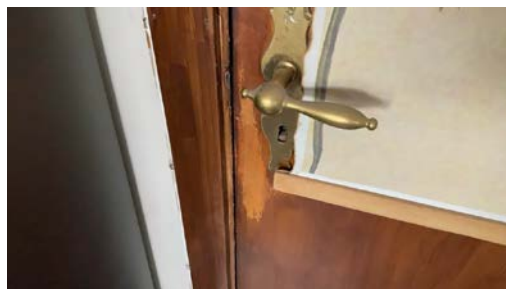
Skade/ slitasje på dør.
