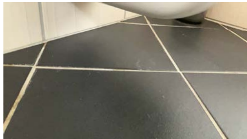
Manglende lekkasjeåpning vegghengt toalett
