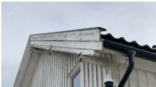
Skade/ slitasje på vindski.
