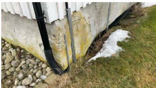
Avskalling på mur.
