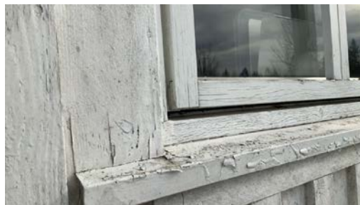
Skade/ slitasje på vindu.
