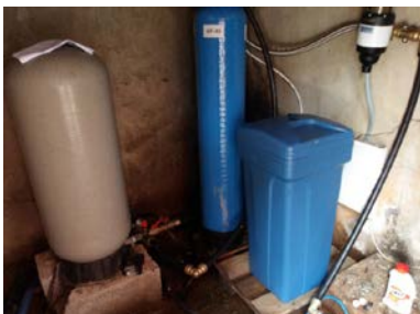
Filter og trykktank for vannbehandling, i pumpehus.
