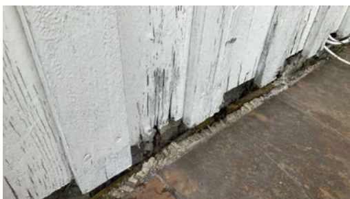
Råteskade på yttervegg.
