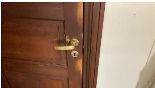
Skade/ slitasje på dør.
