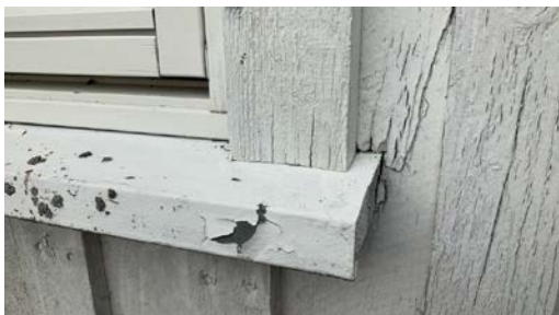
Manglende avstand mellom treverk og vannbrett.
