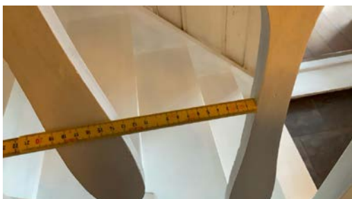
Måling av åpninger i rekkverk på trapp.
