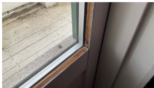
Skade/ slitasje på dør.
