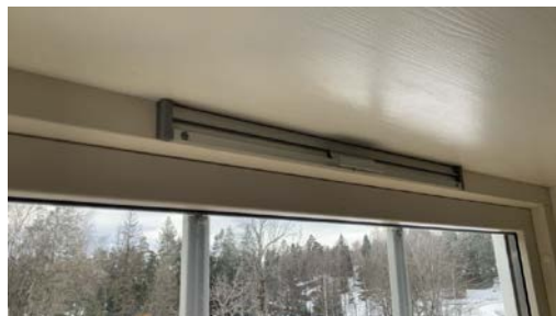
Tilluft fra ventil i vindu
