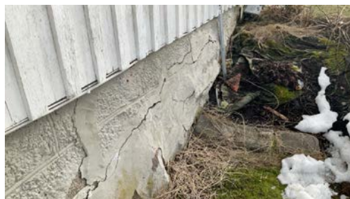
Skade på mur.
