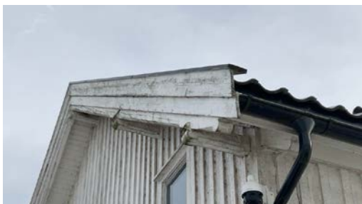
Skade/ slitasje på vindski.
