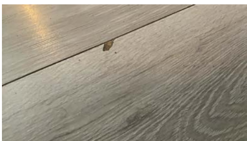
Skade/ slitasje på overflater.
