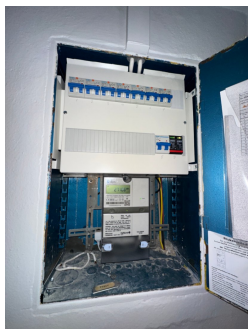
Sikringskap med automatsikringer.
