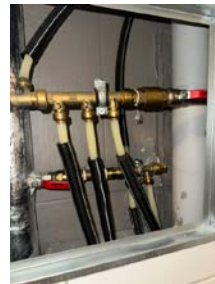
Samleskap med rørkurser og stoppekraner
