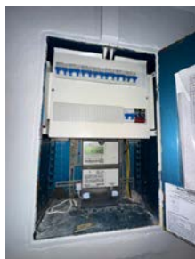
Sikringsskap med automatsikringer.
