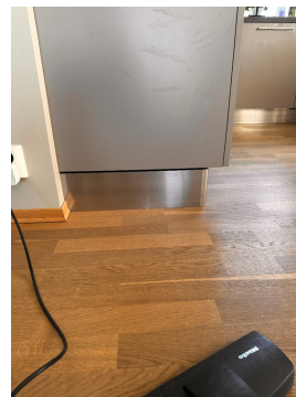
Stor klaring mellom sokkel og kjøkkeninnredning
