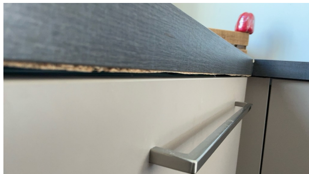
Svelling av benkeplater over oppvaskmaskin
