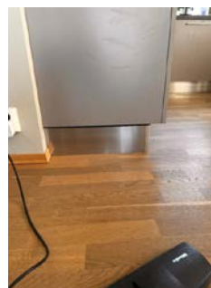
Stor klaring mellom sokkel og kjøkkeninnredning
