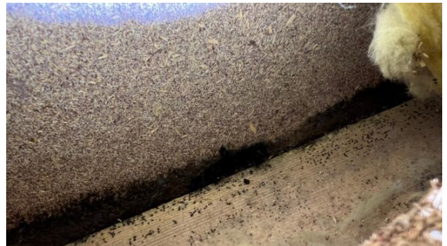
Soppdannelse på nedre del av veggplaten inn mot dusjen.
