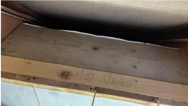
Spor av sopp etter tidligere fuktproblemer
