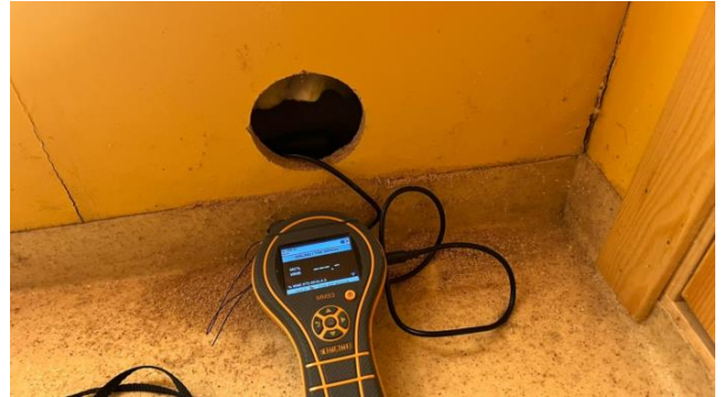
Fuktmåling i veggen mot dusjen.
