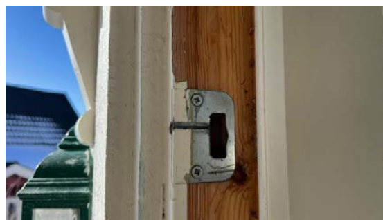
Balkongdøren i underetasjen må justeres.
