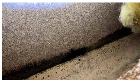
Soppdannelse på nedre del av veggplaten inn mot dusjen.
