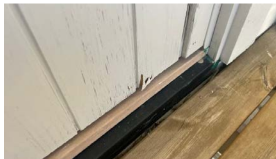
Skade på balkongdøren
