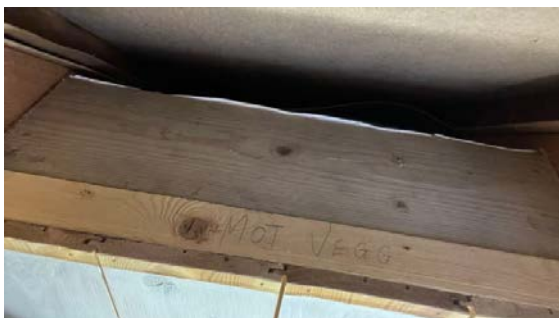
Spor av sopp etter tidligere fuktproblemer
