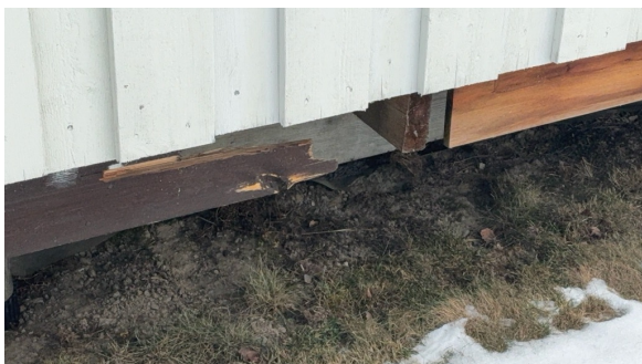
Skade på forkantbord.
