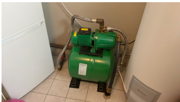
Vanninntak og stoppekran.
