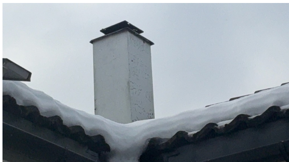
Avskaling på overflater på pipe.
