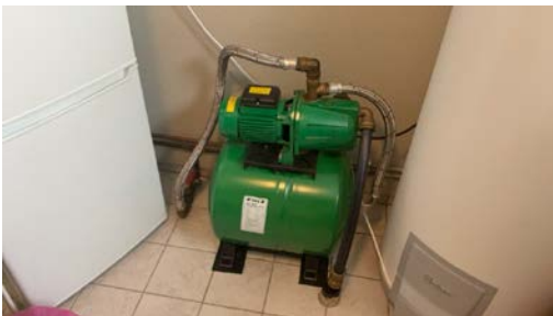
Vanninntak og stoppekran.
