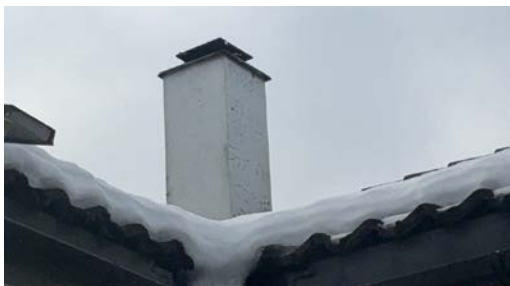
Avskaling på overflater på pipe.
