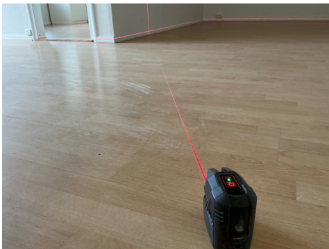
Nivellering stue/kjøkken + soverom, avvik ca. 10-20 mm
