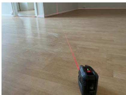
Nivellering stue/kjøkken + soverom, avvik ca. 10-20 mm
