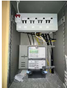
Sikringskapp med automatsikringer.
