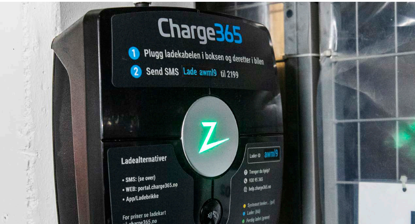
Ladeboks for EL-bil er montert på plassen
