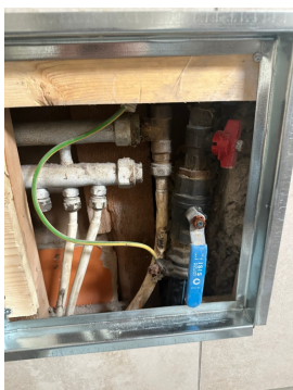
Vanntilførsel med eldre kobberør
