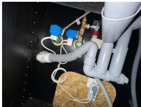
Røropplegg i kjøkkenbenk med Waterguard
