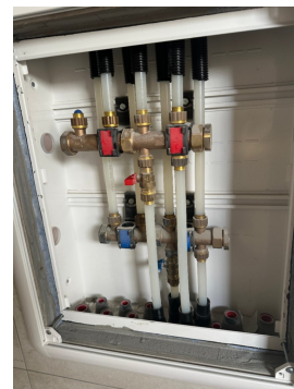
Samleskap med rørkurser og stoppekraner
