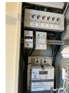
Sikringsskap med automatsikringer.
