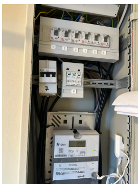
Sikringsskap med automatsikringer.
