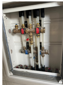
Samleskap med rørkurser og stoppekraner
