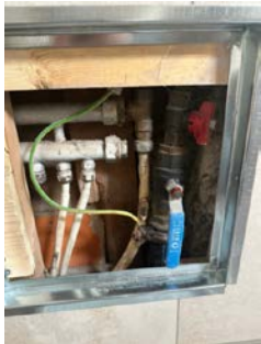
Vanntilførsel med eldre kobberør
