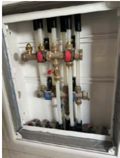
Samleskap med rørkurser og stoppekraner
