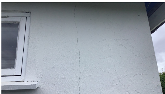
Riss i murvegg.
