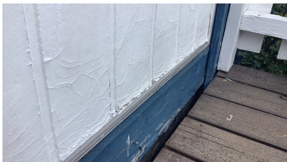
Svelling på dør fra vaskerom.
