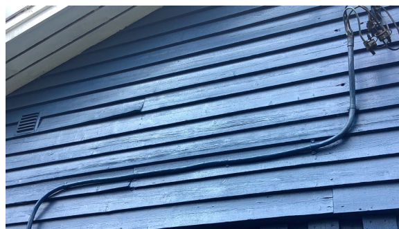
Vridd og sprukket bordkledning.
