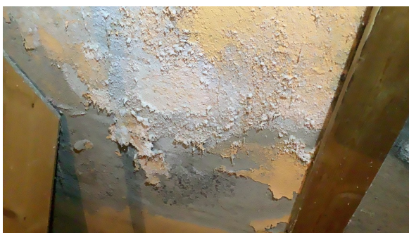
Eksempel på saltutslag.
