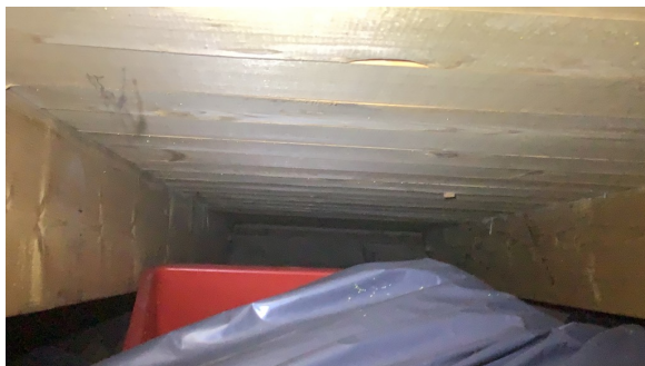
Mangelfull luftespalte fra takfot.
