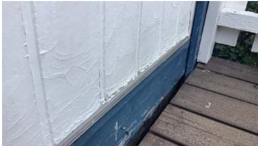
Svelling på dør fra vaskerom.
