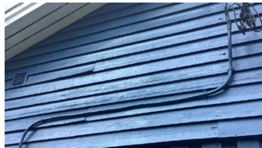
Vridd og sprukket bordkledning.
