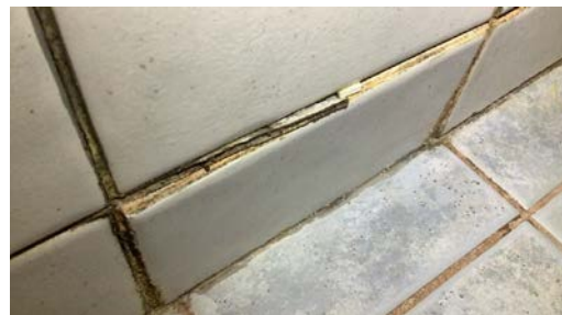
Flis har løsnet som følge av fuktskader i vegg.
