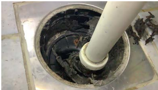
Plastsluk, uten synlig tettesjikt.
