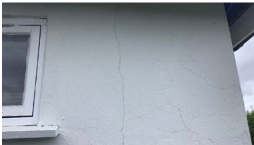
Riss i murvegg.
