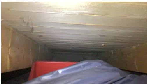
Mangelfull luftespalte fra takfot.
