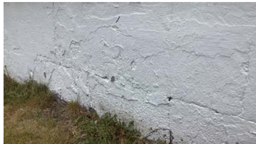
Eksempel på mur med mangelfull puss.
