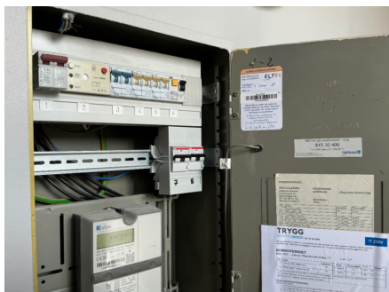
Automatsikringer i sikringsskap plassert i gang/fellesareal.
