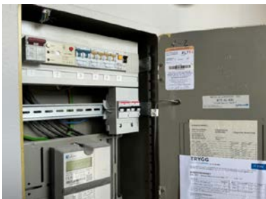
Automatsikringer i sikringsskap plassert i gang/fellesareal.
