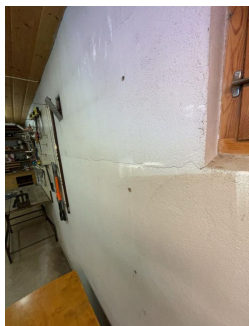
Grunnmuren har sprekkdannelser.
