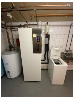
Varmepumpe plassert i tekniskrom.
