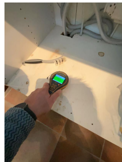
Fuktskjolder/svelling i bunnplate i benkeskap. Ved bruk av fuktindikator registrerte jeg ingen unormale verdier.
