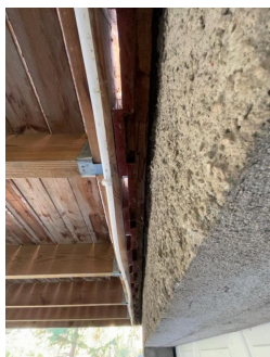
Innfesting direkte i kledning er ikke anbefalt da denne ikke har tilstrekkelig bæring
