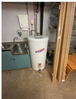
Det er påvist at varmtvannstank er over 20 år
