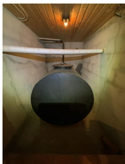
Oljetank er plassert i bod i kjeller.
