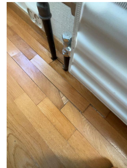
Løse parkettlameller i området rundt radiator rør i stue i 1. etasje.
