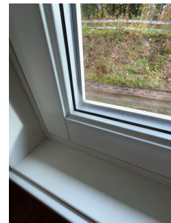
Kondensmerker på enkelte vinduer.
