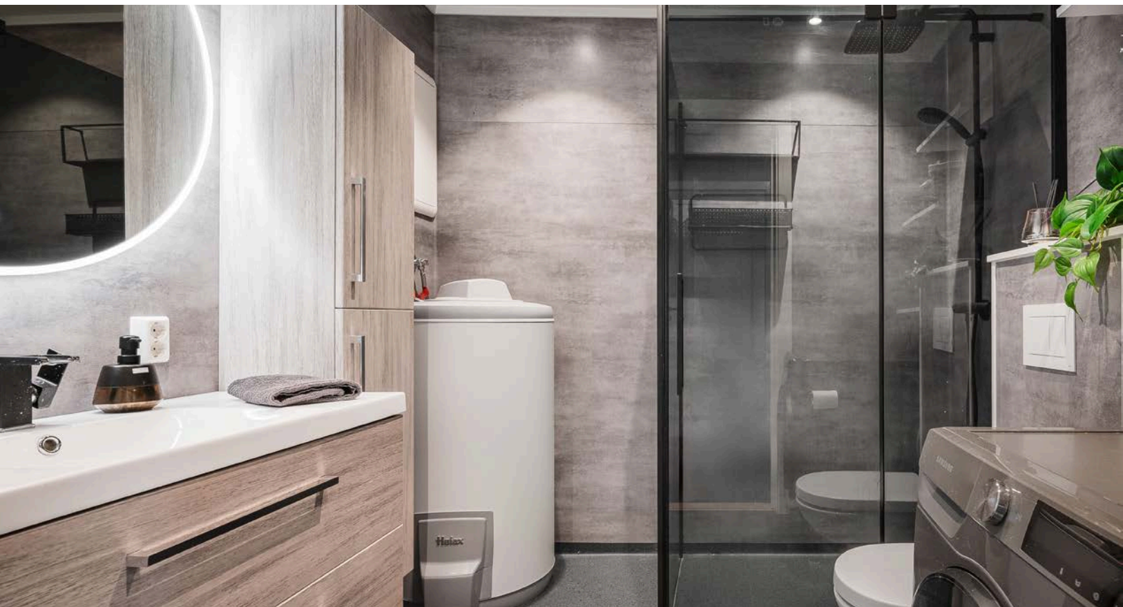
Badet har installasjoner med veggmontert toalett, dusjhjørne med fossefalldusj og glassdører, samt opplegg for vaskemaskin.
