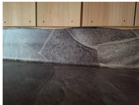
Belegg oppunder panel under servantinnredning
