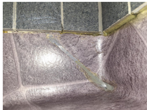
Hjørne i dusjnise, glippe mellom veggflis og belegg
