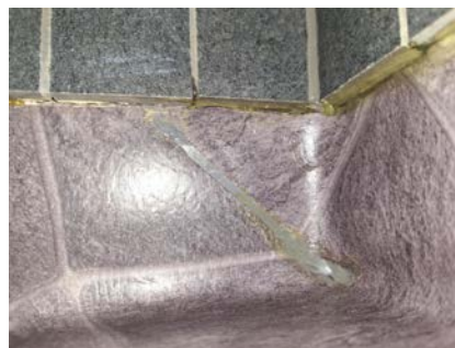
Hjørne i dusjnise, glippe mellom veggflis og belegg
