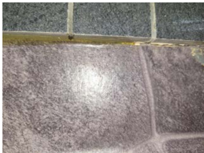
Glippe mellom belegg og fliser i dusjnise
