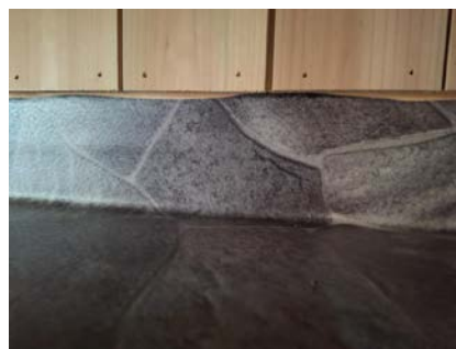
Belegg oppunder panel under servantinnredning
