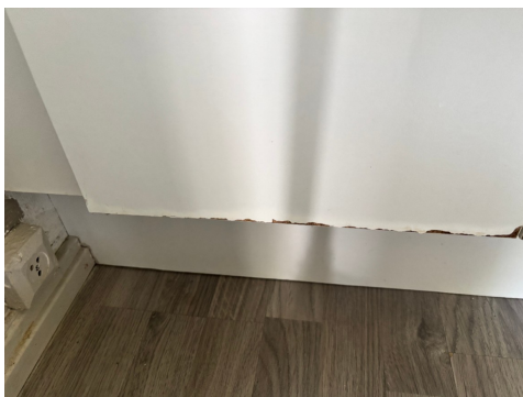
Viser fuktskader på fronter
