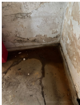
Viser fukt/vann og saltutslag i kjeller
