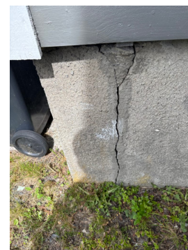
iser 1 av flere sprekker i grunnmuren.
