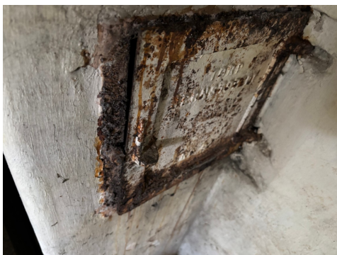
Viser feieluke i kjeller. (utett + defekt lås)
