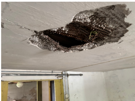
Viser hull i tak/puss i kjeller
