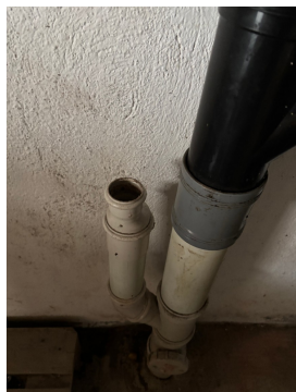
Viser åpent avløpsrør som må tettes.
