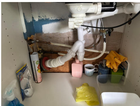
Viser røropplegg i kjøkkenbenken.
