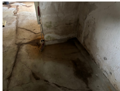
Viser fukt/vanninnsig i kjeller
