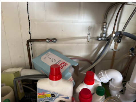
Viser røropplegg i benkeskapet.
