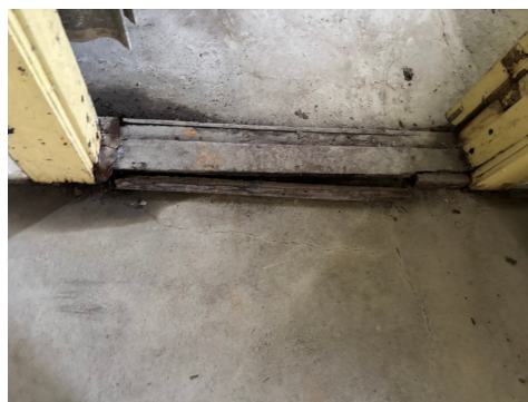
Viser fukt/råte i kjellerdør.
