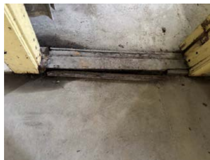
Viser fukt/råte i kjellerdør.
