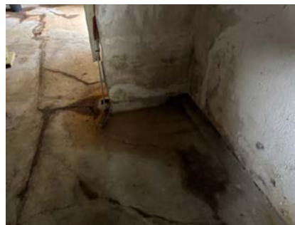
Viser fukt/saltutslag og sprekker i gulv og vegger.
