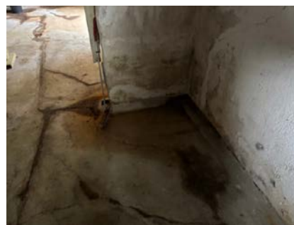
Viser fukt/vanninnslag i kjeller
