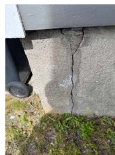
Is 1 av flere sprekker i grunnmuren.
