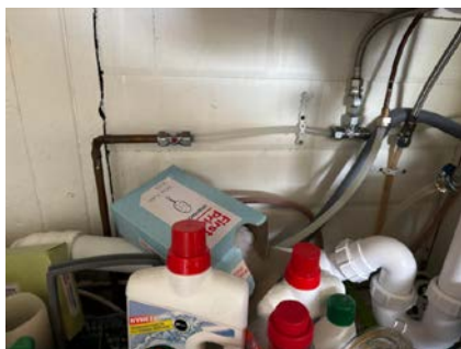
Viser røropplegg i benkeskapet.
