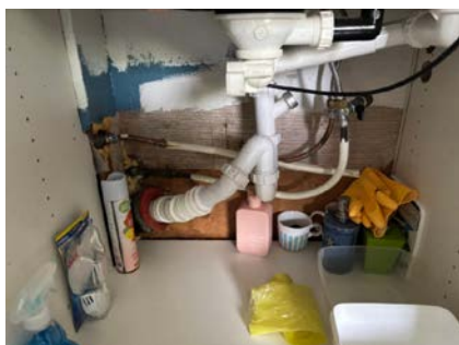
Viser røropplegg i kjøkkenbenken.
