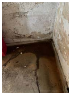
Viser fukt/vann og saltutslag i kjeller
