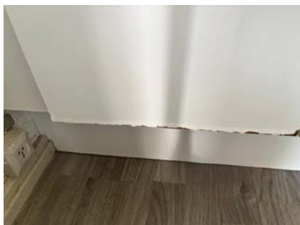
Viser fuktskader på fronter
