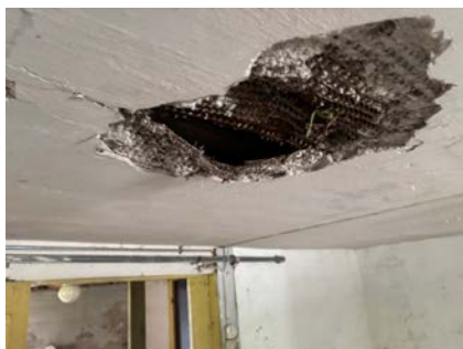
Viser hull i tak/puss i kjeller
