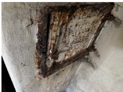
Viser feiluke i kjeller. (utett + defekt lås)
