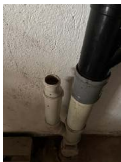
Viser åpent avløpsrør som må tettes.
