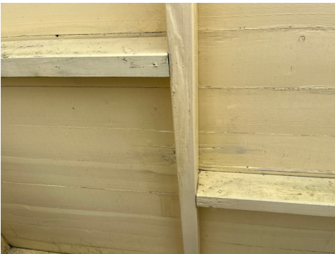
Råteskade i levegg.
