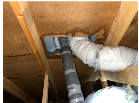
Fuktmerker i undertak i gjennomføring.
