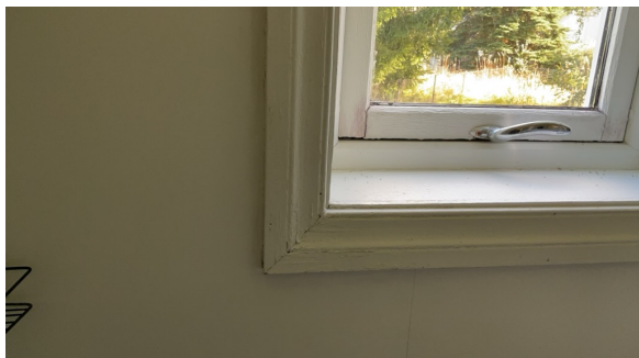
Fuktskader på vindu i våtsone.
