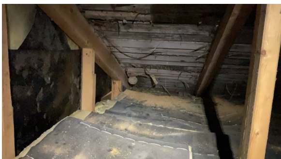
Kondelsmerker og muggsopp i overflater på undertak.
