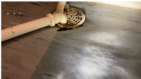
Hull i belegg ved sluk.
