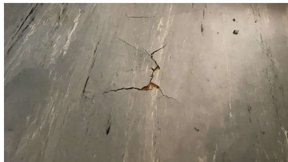
Skader/hull på belegg.
