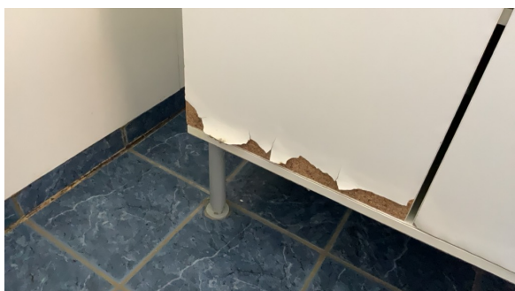
Skader på innredning.
