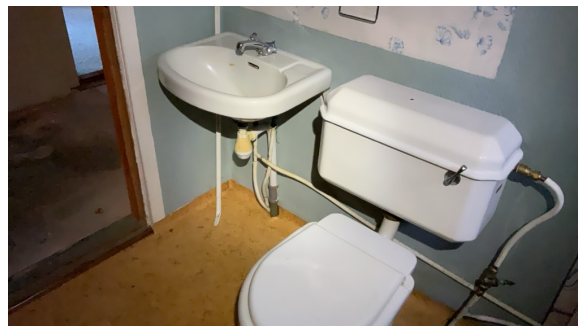
Eldre installasjon av toalett og servant.
