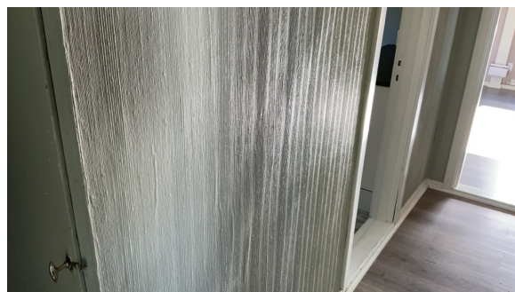
Tapet løsner fra underlag.
