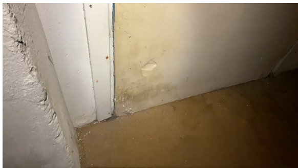
Skader på ytterdør i kjeller.
