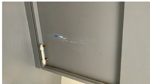
Slitasje på innredning.
