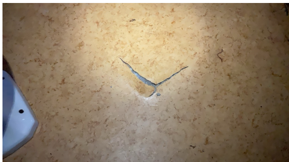
Hull i gulvbelegg.
