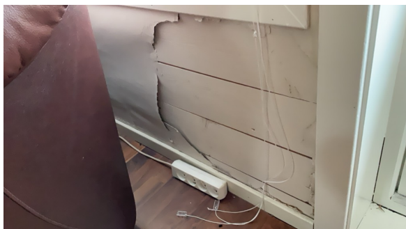
Skader på overflater.
