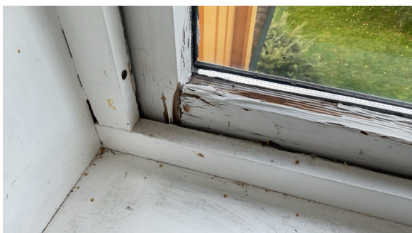
Fuktskade og kondensmerker på flere vinduer.
