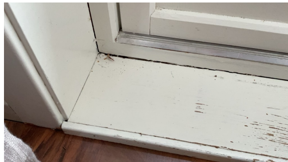
Slitasje på utforing terrassedør.
