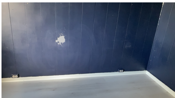
Manglende håndverksmessig utførelse på deler av arbeid.
