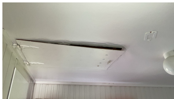
Det anbefales å isolere loftsluken og tette området rundt den for å forhindre luftlekkasjer.
