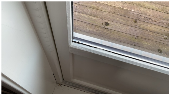
Kondensmerker på terrassedør.
