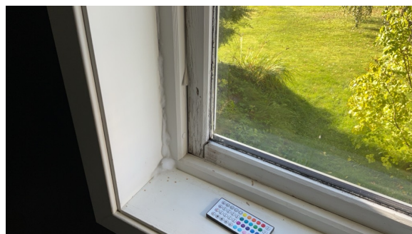
Vindu på ene soverom 1. etasje lar seg ikke åpne. Dette vinduet gis isolert sett TG3 og tiltak/utskifting må utføres.
