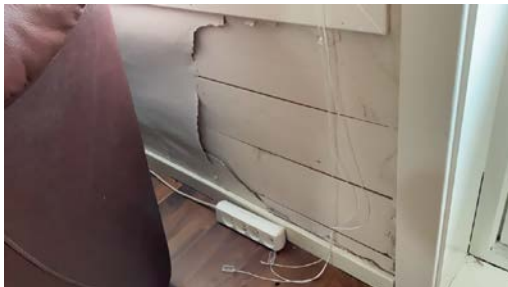
Skader på overflater.
