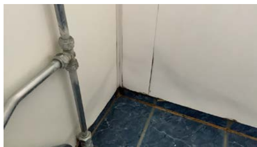
Svelling/fuktskader på våtromsplater.
