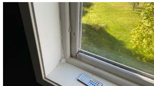
Vindu på ene soverom 1. etasje lar seg ikke åpne. Dette vinduet gis isolert sett TG3 og tiltak/utskifting må utføres.
