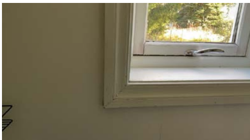
Fuktskader på vindu i våtsone.
