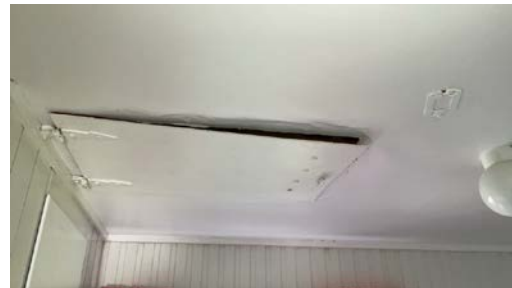
Det anbefales å isolere loftsluken og tette området rundt den for å forhindre luftlekkasjer.
