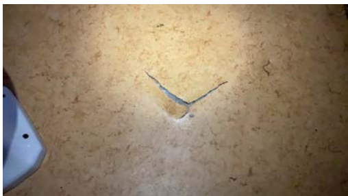
Hull i gulvbelegg.
