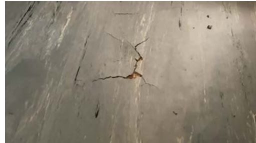
Skader/hull på belegg.
