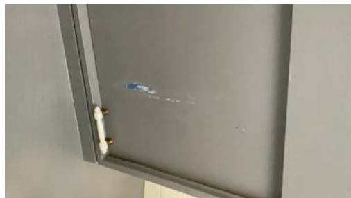
Slitasje på innredning.
