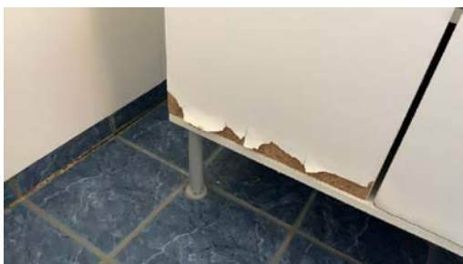
Skader på innredning.
