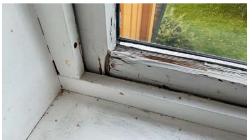
Fuktskade og kondensmerker på flere vinduer.
