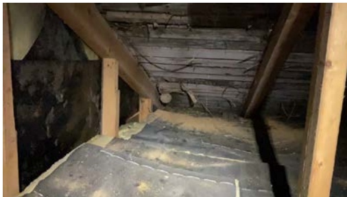
Kondelsmerker og muggsopp i overflater på undertak.
