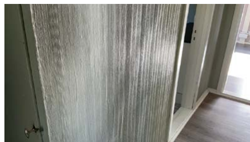
Tapet løsner fra underlag.
