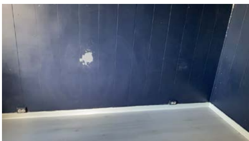
Manglende håndverksmessig utførelse på deler av arbeid.
