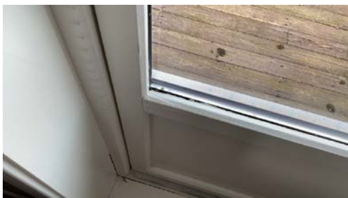
Kondensmerker på terrassedør.
