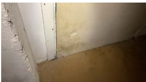
Skader på ytterdør i kjeller.
