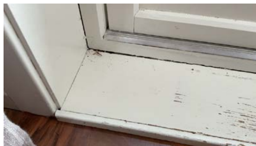
Slitasje på utforing terrassedør.
