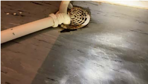
Hull i belegg ved sluk.
