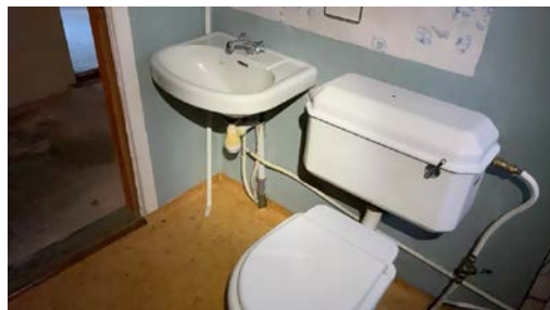
Eldre installasjon av toalett og servant.
