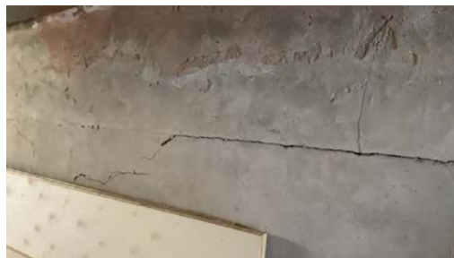
Sprekker i mur i garasje, som er fundamentering til terrasse 1. etasje
