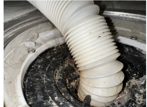
Fra sluk synlig slukmansjett under klemring
