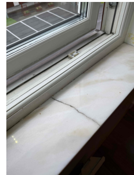
Bildet viser sprekk i vindusbrett.
