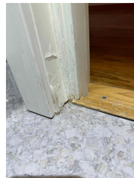
Bildet viser svelling/fuktskade på foringen til baderomsdøren.
