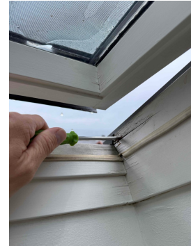
Bildet viser takvindu med råteskade.
