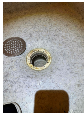
Bildet viser sluk med manglende vannlåsinnsetts.
