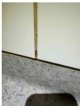
Bildet viser spekk/riss i flisfuge.
