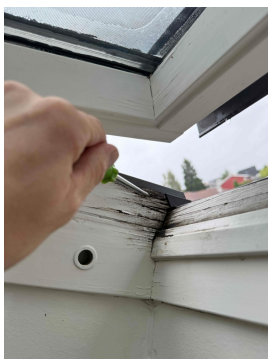
Bildet viser takvindu med råteskade.
